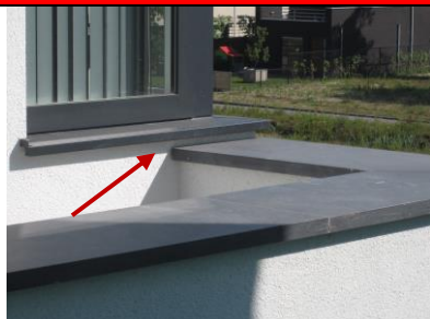
Ontbreken van een neut (opstaande rand). Kans op inwatering.
