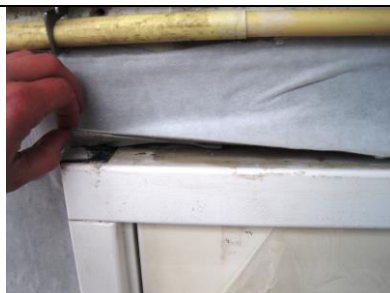
Hechtvlak op kozijn niet vet- en stofvrij. Hierdoor onvoldoende hechting.
