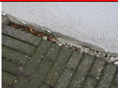
Geen bitumen aangebracht en straatwerk koud tegen het stucwerk.
