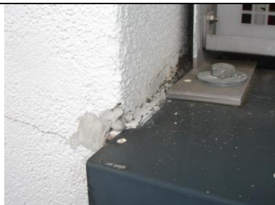
Scheurvorming en onthechting door afwezigheid eindkap muurafdekker.
