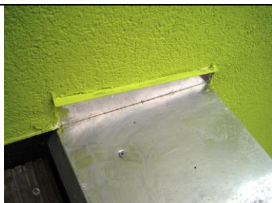
Vast eindstuk aan muurafdekker. Deze is qua ontwerp en maatvoering niet correct.
