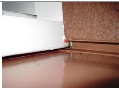
Ontbreken van rubber (drain) achterzijde kopschot. Kans op inwatering in pleisterlagen en achter het gevelisolatiesysteem.
