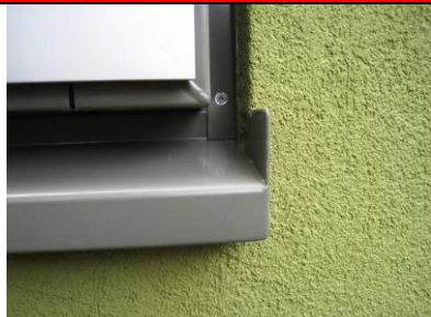
Metselwerk kopschot i.p.v. een stucwerk kopschot.
