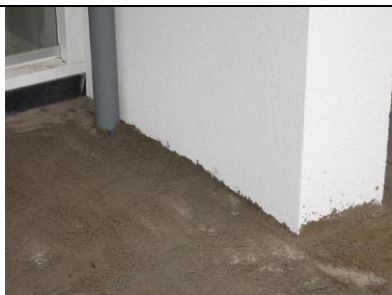
Grondlaag hoger dan de aangebrachte bitumenlaag.
