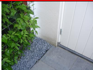
Optrekkend vocht door ontbreken bitumen onder het maaiveld.
