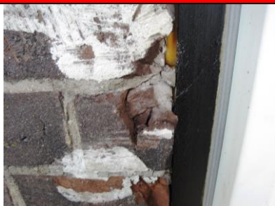
Ondergrond niet stabiel en vlak.
