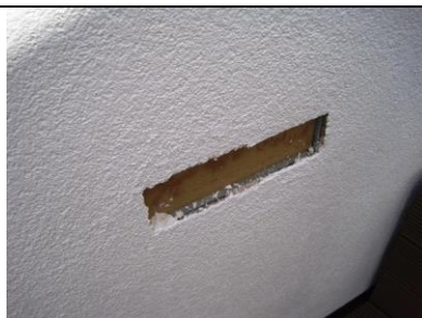
Gevelattribuut nog niet aangebracht. Inwatering in- en achter het gevelisolatiesysteem met stucwerk.
