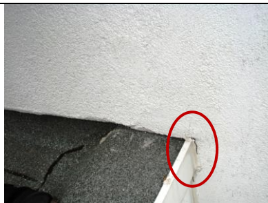
Scheurvorming in stucwerk bij aansluiting daktrim.
