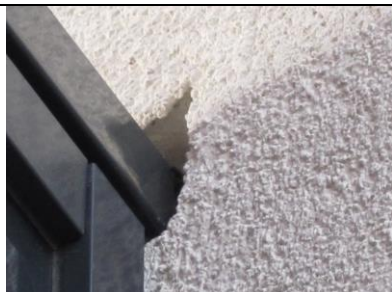
Daktrim in gevelstuc aangebracht zonder extra voorzieningen voor waterdichte aansluiting. Kans op inwatering.
