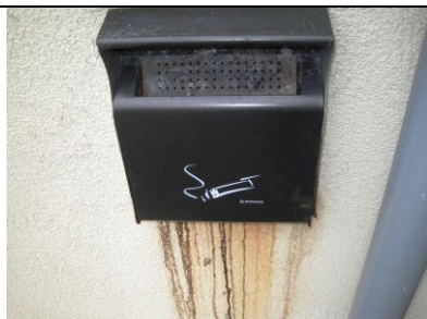
Vervuiling van sierpleister. Remedie: opnieuw monteren met afstandhouders.
