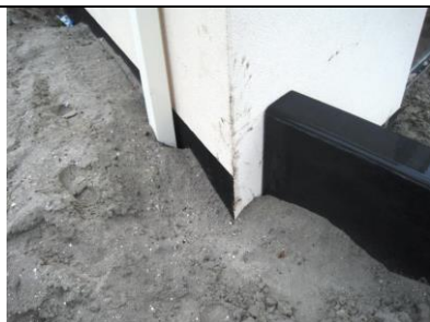
Ontbreken van bitumen.
