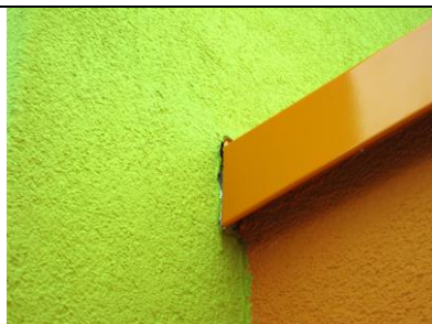
Aansluiting tussen daktrim en opgaand gevelstucwerk niet waterdicht.
