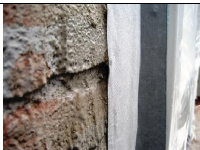
Ondergrond is niet uitgevlakt. Luchtlekken aanwezig.
