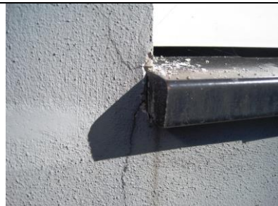
Scheurvorming en verzeping van het stucwerk t.p.v. kopse kant raamdorpel door ontbreken van een neut (opstaande rand).
