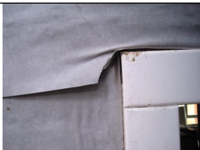
Band onderling niet voorzien van primer. Hierdoor onvoldoende hechting.
