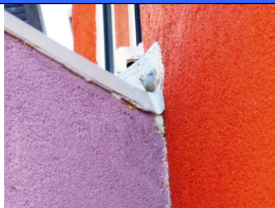
Onthechting en verzeping van stucwerk. Kunststof dakbedekking rechtstreeks op sierpleister aangebracht.
