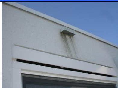
Vervuiling stucwerk door verkeerd geplaatste opening noodoverloop.
