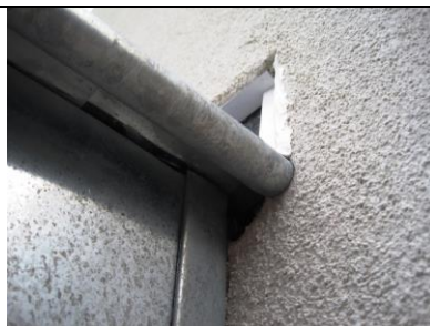
Aansluiting tussen kraal, gevelstucwerk en muurplank niet waterdicht en niet sluitend.
