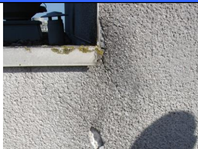
Muurafdekker zonder eindstuk. Inwatering is oorzaak van aanwezige scheurvorming en onthechting.
