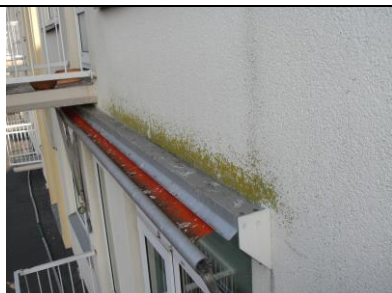
Vervuiling (mos en alg) t.p.v. zonneluifel door opspattend water van omkasting.
