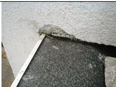
Onthechting van stucwerk door uitzetting van daktrim tegen het aanwezige sokkelprofiel.
