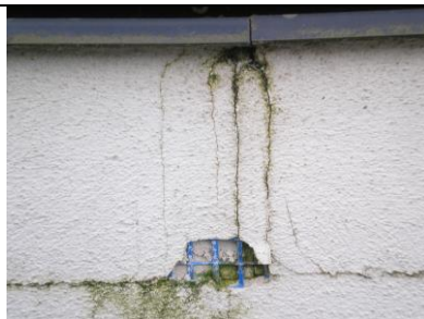
Koppelstrip muurafdekker niet waterdicht. Inwatering in stuclagen.
