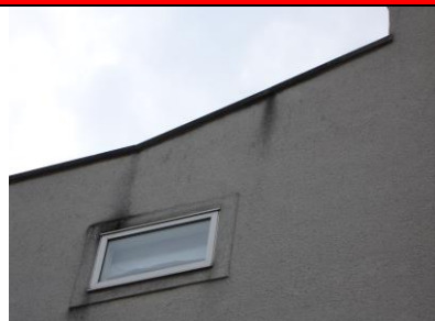
Stuiknaden niet waterdicht. Voorkeur voor afschot naar dak i.p.v. gevel. Onvoldoende overstek.
