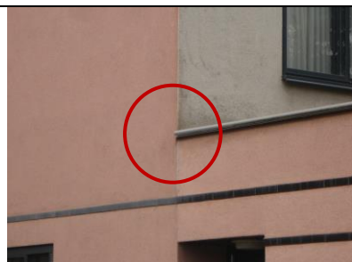
Ontbreken van een eindkap. Kans op inwatering en vuilstrepen.
