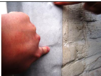
Band niet goed aangerold t.p.v. de voegen. Bij voorkeur verdiepte voegen aanhelen.
