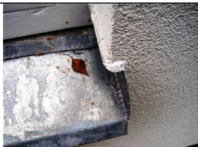
Vast gelast kopschot met dakje. Waterslag kan niet afzonderlijk uitzetten en zal bij thermische uitzetting het stucwerk beschadigen.
