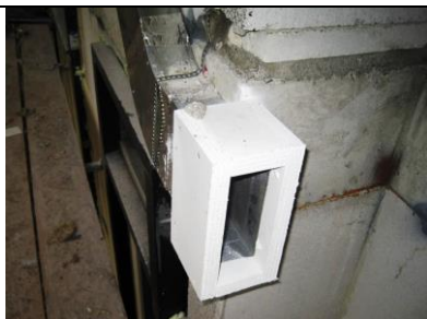
Ventilatie afvoer verstevigd met een houten behandelde klos.
