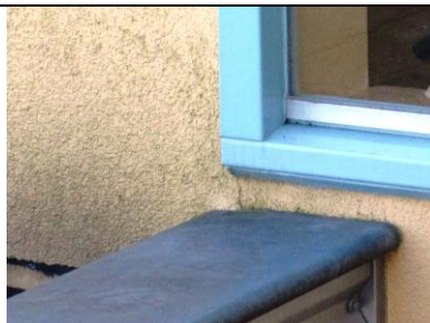
Onthechting stucwerk door ontbreken van eindkap met dakje.
