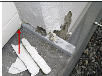
Inwatering op neut (foutieve maatvoering) en via achterhoek van de raamdorpelsteen.
