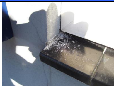
Scheurvorming door inwatering bij raamdorpelsteen (geen neut aanwezig).
