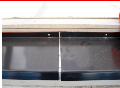
Geen waterdichte koppelstrip aangebracht. Kans op inwatering.
