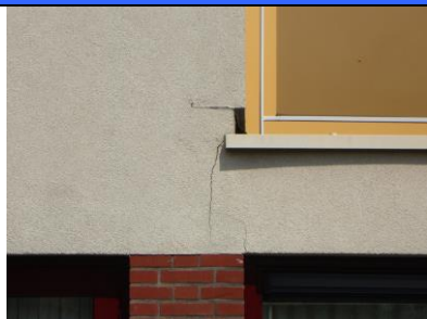
Muurafdekker zonder los eindstuk. Scheur door drukbelasting (thermische uitzetting muurafdekker).
