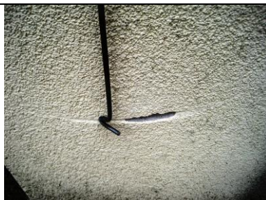
Beschadiging stuclagen door krassen deurhaak.
