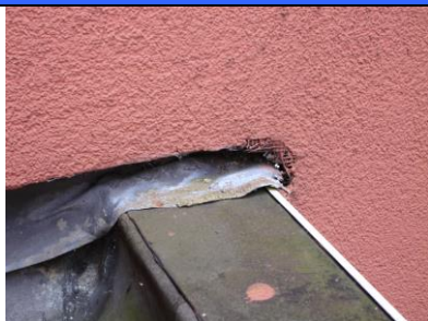
Onthechting van stucwerk t.p.v. loodslabbe. EPS en weefsel nog zichtbaar.
