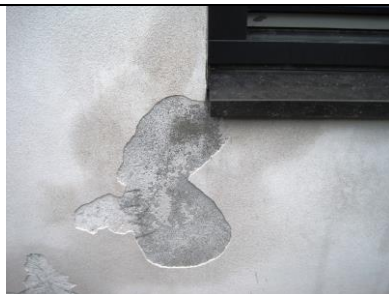
Onthechting stuclagen door inwatering bij raamdorpel.
