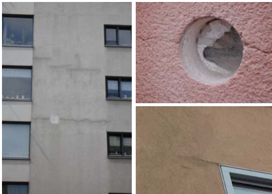
Afbeelding 3: De aard en omvang van scheuren is bepalend voor het herstel. Goede analyse moet uitwijzen hoe ingrijpend het benodigde herstel-onderhoud is.
